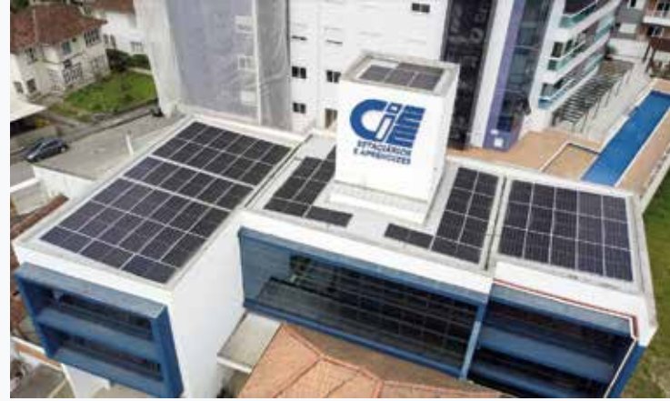
Placas solares instaladas no prédio do CIEE/SC em Joinville
